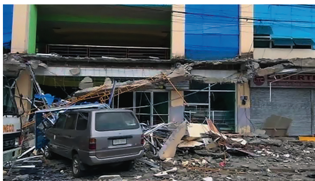
Торговый центр после землетрясения на острове Минданао (Филиппины). 31 октября 2019 г.
